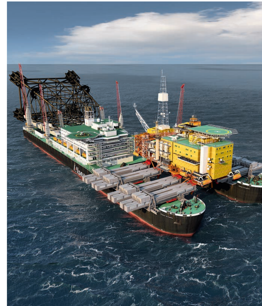
Le plus grand navire spécial au monde pour l'assemblage et le démontage des plates-formes de forage pétrolier
